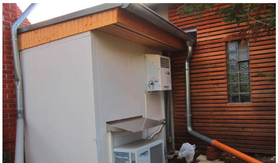
Neuer, an der Gebäuderückseite errichteter, Aufstellraum für eine Kombikühlzelle.
