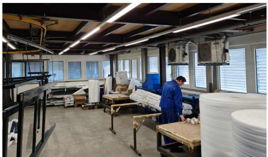
Neue energieeffiziente LED-Leuchtbänder sorgen für optimale Arbeitsbedingungen
