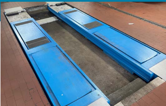
Moderne und energieeffiziente Hebebühne bei der ASR GmbH & Co.KG.
