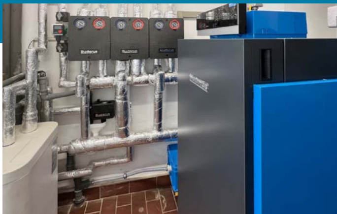
Neue Gas-Brennwerttherme zur energieeffizienten Wärmeerzeugung.
