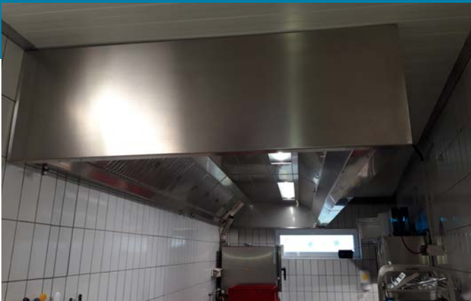
Neues Zu- und Abluftsystem in der Landschlachterei Ferchland.
