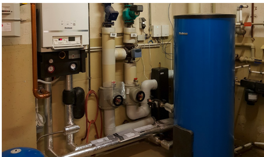
Mit effizienter Gas-Brennwerttechnik und Schichtladespeicher modernisierte dezentrale Wärmeversorgung.
