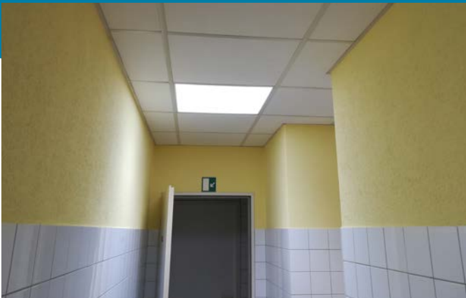
LED-Einlegeleuchten mit Tageslichteffekt.
