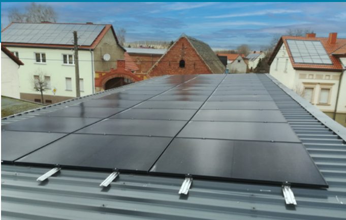
Neu errichtete PV-Anlage zur Produktion von Eigenstrom auf dem Werkstattdach
