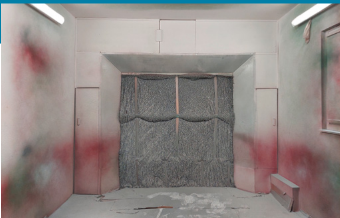
Eine neue, energiesparende und strömungseffiziente Farbnebelabsauganlage in der Lackierkabine wurde installiert.
